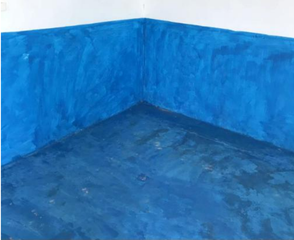
图 3-8 危险废物暂存仓库防渗
