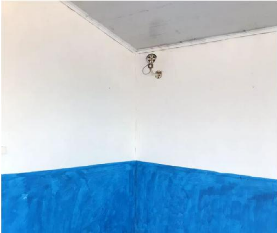
图 3-7 危险废物暂存仓库内部监控
