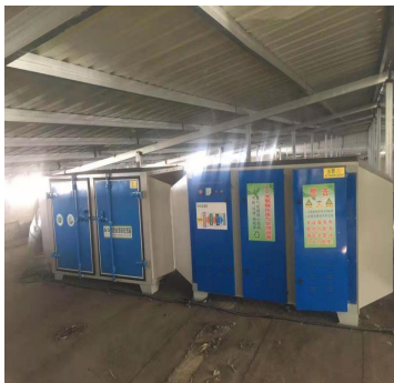
图 2-4 废气治理设施
