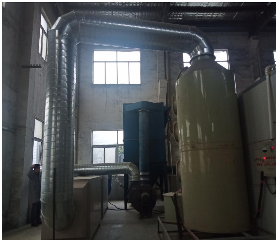
图 4-2 废气处理设施
