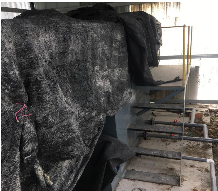
图 4-2 一体化净化设备废水处理设施
