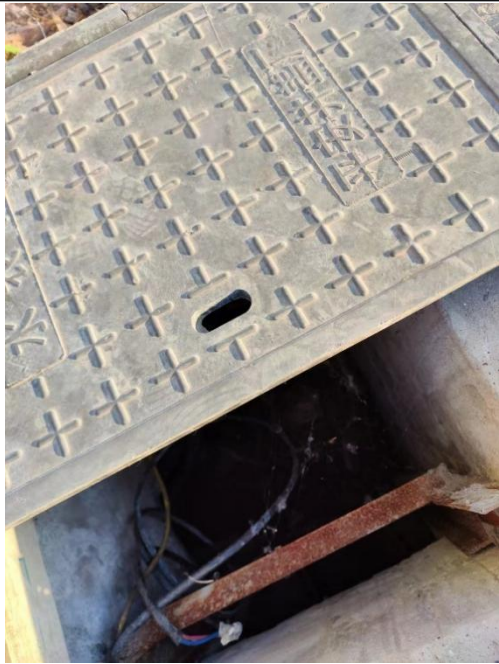
图 3-3 厂区污水总排
