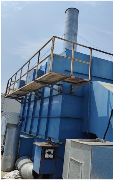
图 3-5 废气处理设施
