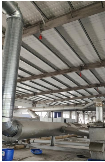
图 3-6 废气收集管路
