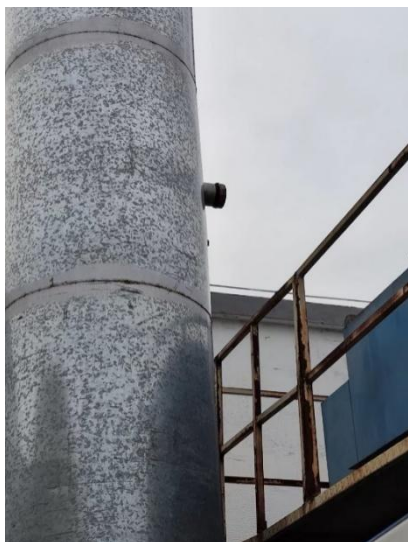
图 3-8 废气监测孔及采样平台
