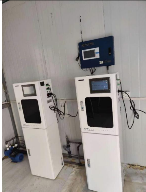
图 3-4 污水在线监测设施
