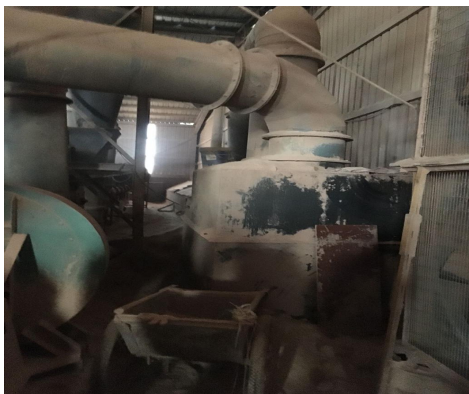
图 4-1 废气处理设施（除尘水箱）
